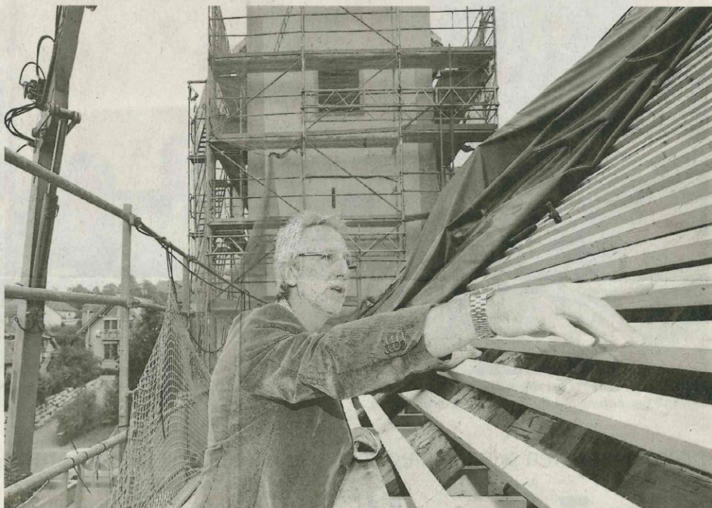
Reinhard Künle vom Erzbischöflichen Bauamt in Konstanz auf dem Dach der Kirche St. Leonhard in Weiler. Die Erzdiözese Freiburg investiert rund 600 000 Euro in die Außensanierung der Kirche.
